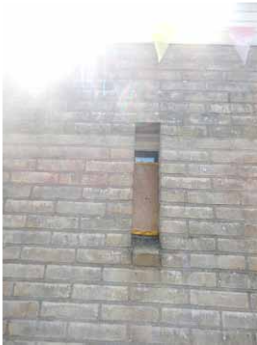
raam tpv voorgevel is dichtgezet met plaat
