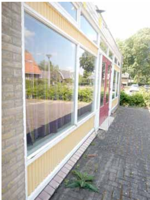
achterstallig schilderwerk houtwerk buiten
