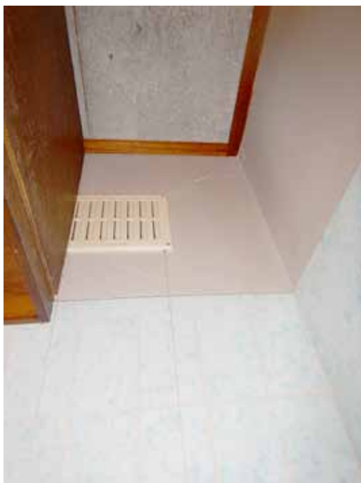
idem; natuurlijke ventilatie in wand, scheuren in wand rondom rooster
