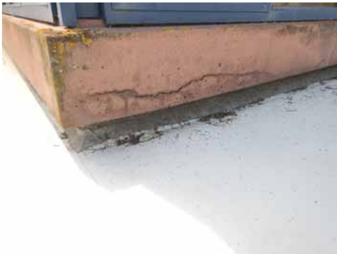
idem; zware scheuren in het beton door roestende wapening
