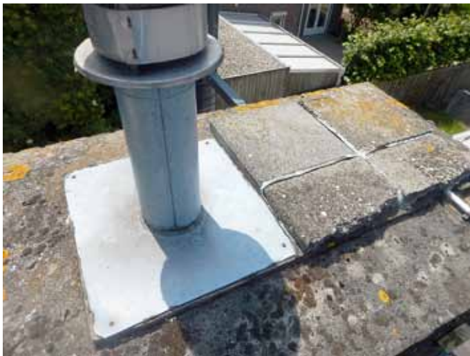
ondeugdelijke afdekking afvoer op schoorsteen door tegels en door zinken plaat op kitwerk
