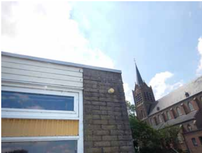
enige slijtage voegwerk gevels
