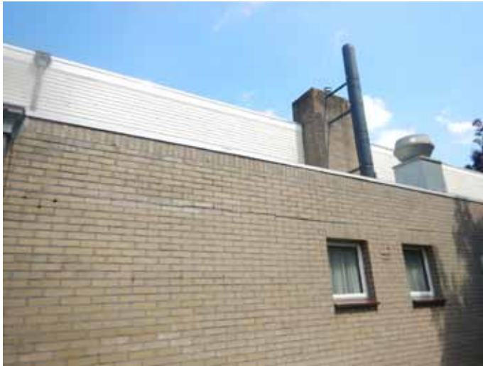
horizontale scheuren in achtergevel
