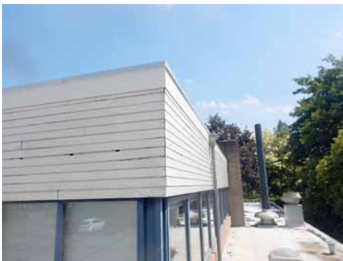
veel rotte delen gevelbetimmeringen hoger gelegen deel
