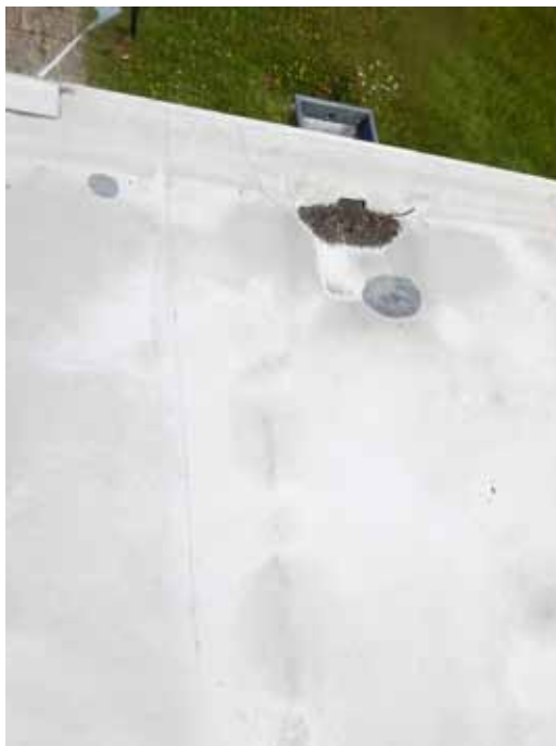
de afvoeren moeten worden schoongemaakt
