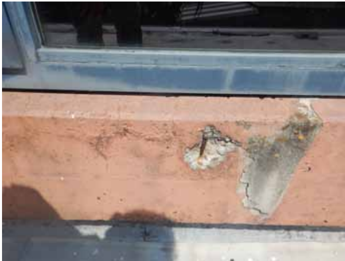
idem; scheuren in het beton door roestende wapening
