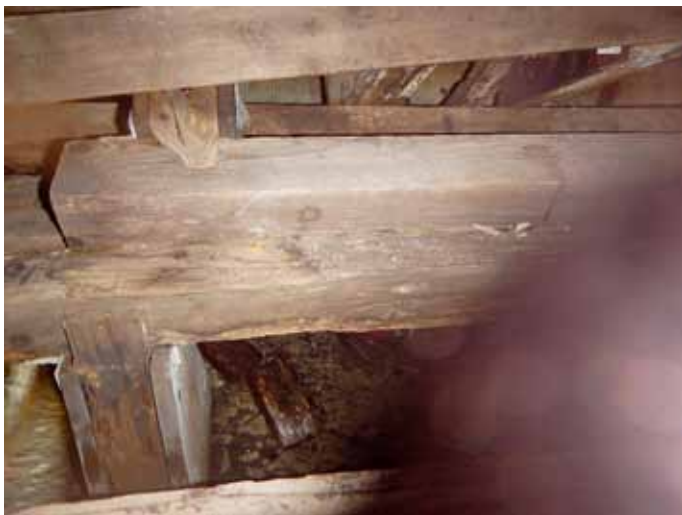
veel slooponderdelen in de kruipruimte, rotte delen en mogelijk aantastingen door insecten; dringend advies is de gehele kruipruimte vrij te maken
