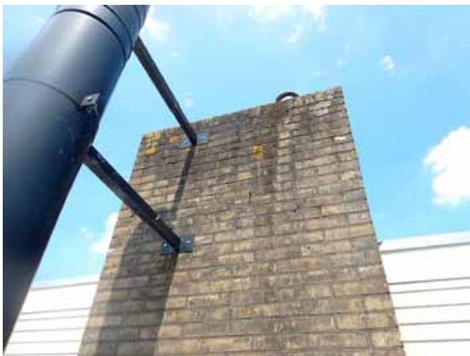
slijtage voegwerk schoorsteen is zichtbaar
