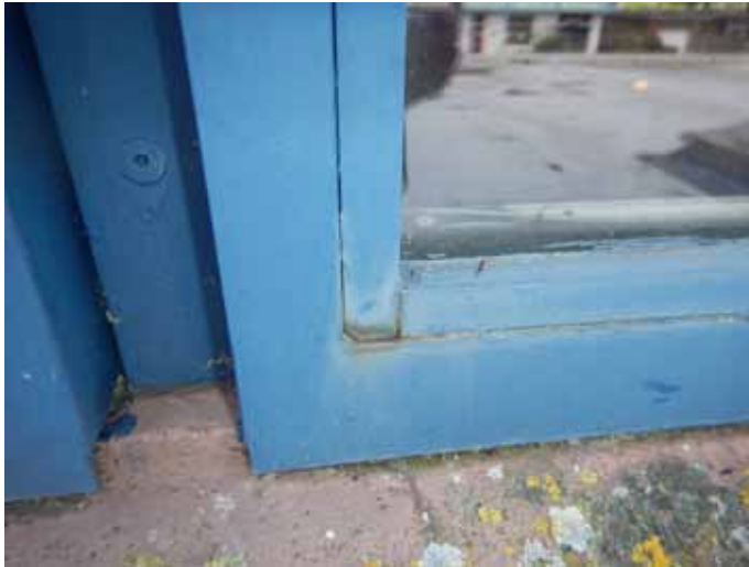
roestende delen kozijnen; zwaar achterstallig schilderwerk
