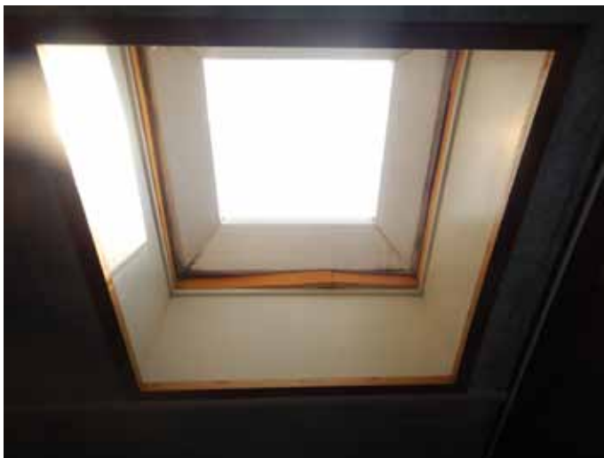
idem; lekkageplekken tpv daklicht
