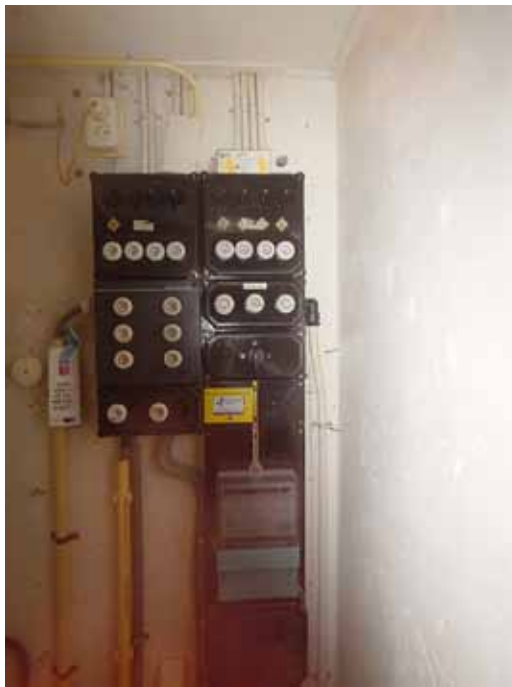
de meterkast; oude groepkasten; geen aardlekschakelaar aanwezig
