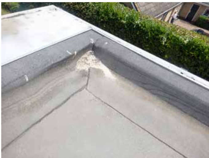
op enige plaatsen craquelé in bitumen
