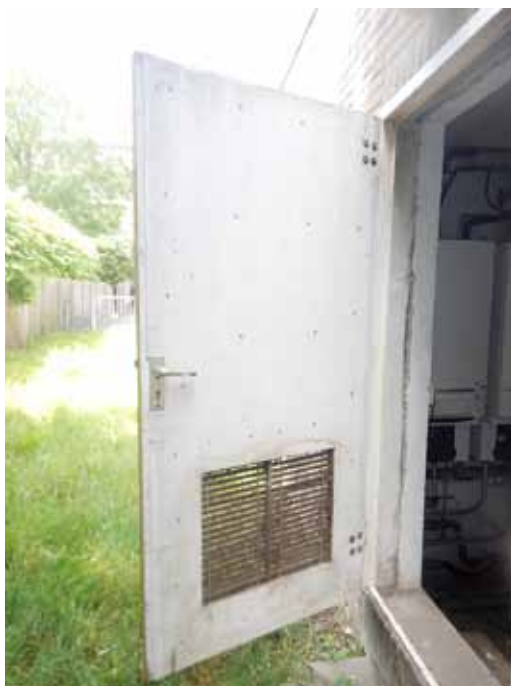
mogelijk asbesthoudende platen tegen deur
