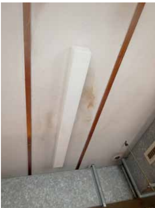
idem; mogelijk asbesthoudend plafond
