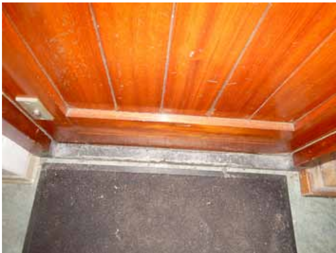
deur rechterzijgevel; beschadigde onderdorpel
