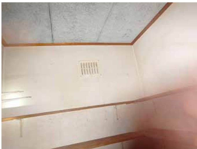
ventilatioerooster in buitenwand werkkast
