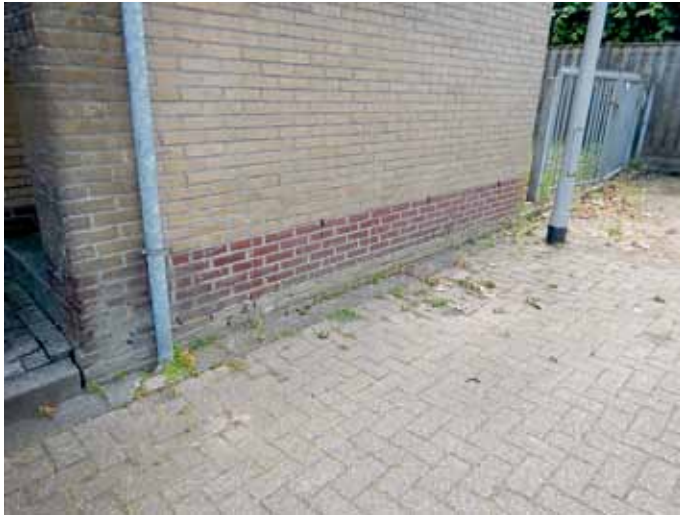
voegwerk onderzijden gevels moet worden hersteld
