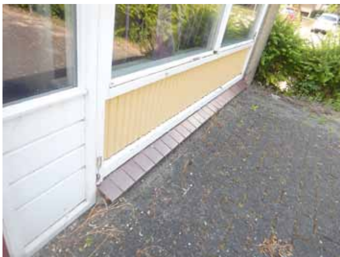
idem; redelijk veel rotte delen houtwerk
