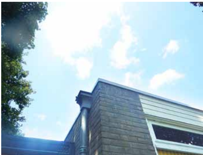
scheur in metselwerk hoek achterzijde
