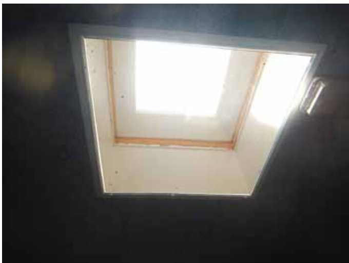
idem; het daklicht; geen deugdelijke afwerking, isolatieplaat dak is zichtbaar
