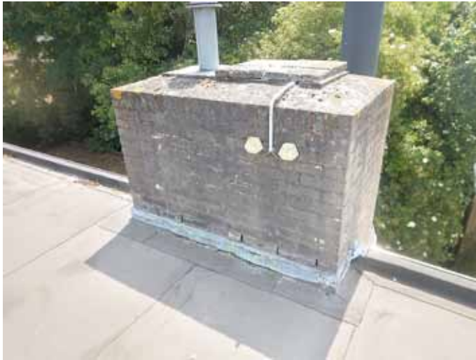
matig loodwerk rondom schoorsteen
